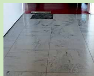
Asbest als Bestandteil von alten Fußbodenbelägen aus Kunststoff (Floor-Flex-Platten) Quelle: Wikipedia
