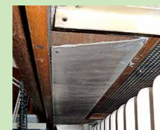
Asbestpappe unterhalb eines Fensterbretts Quelle: www.srf.ch
